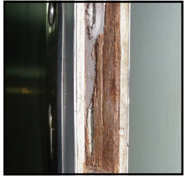
Asbestos Fire Door
